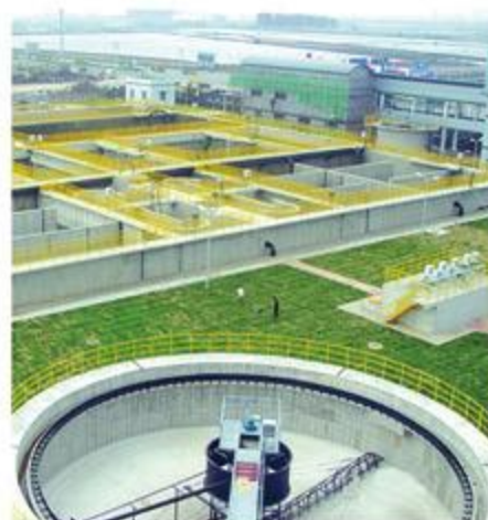
▲ 废水处理工程
