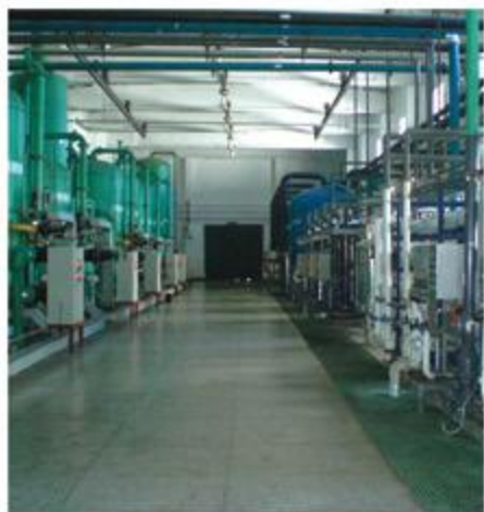
▲ 纯水制备工程
